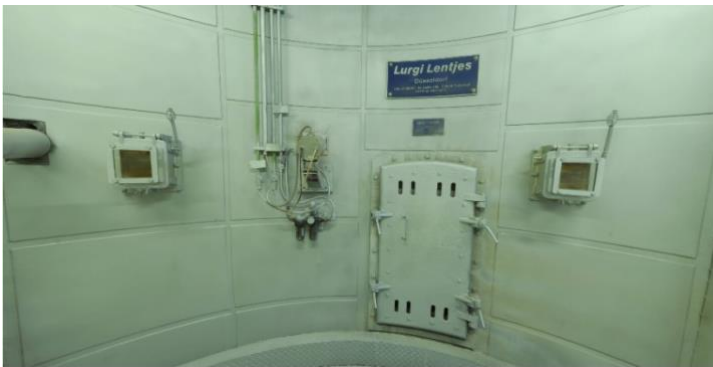
14.16. ábra. Levegőelosztó kamra (forrás: fkf.hu )
